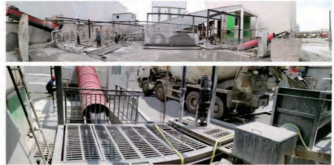
砂石分离及污水处理设备湘坪商砼有限公司现场实景
